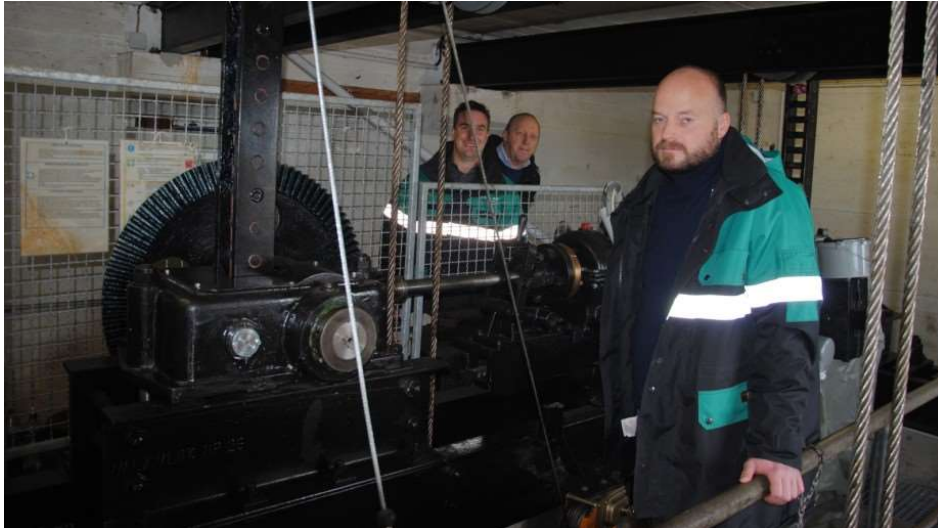
Maschinenhaus des Hafensiels: Florian Schröter (vorne), Fabian Lücht und Ernst-August Thams (hinten v. l.) Foto: hhr
