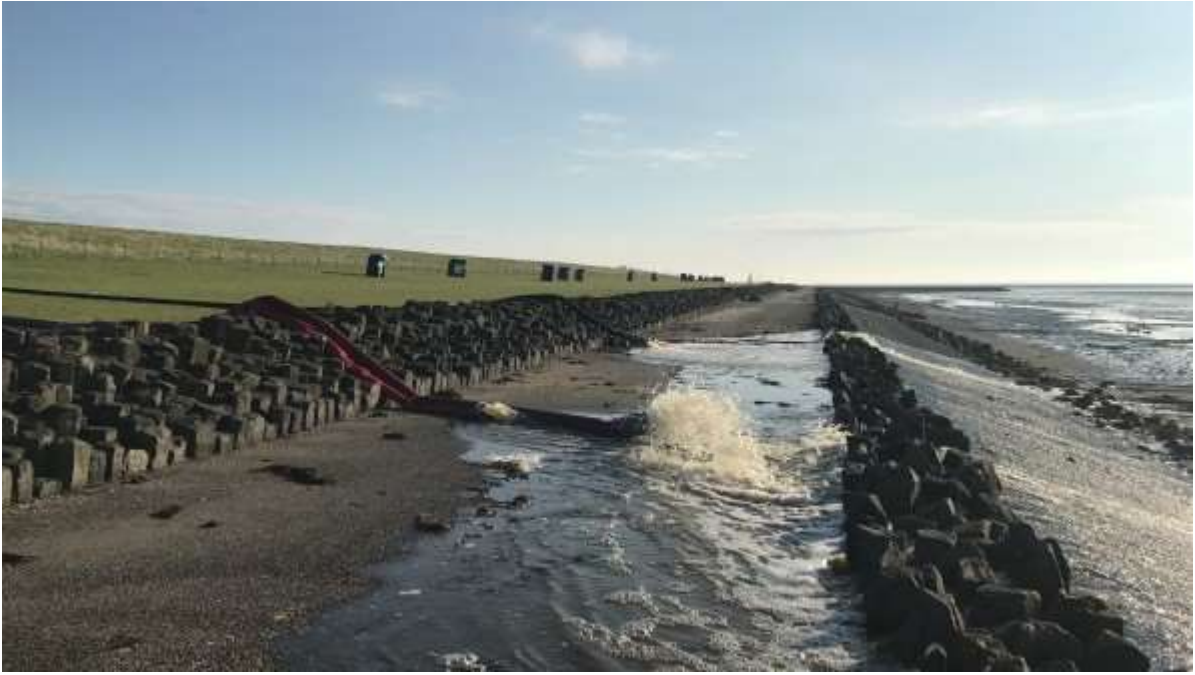
Das Regenwasser wird am Hafensiel in die Nordsee abgepumpt. Foto: Lea Marie Thams
